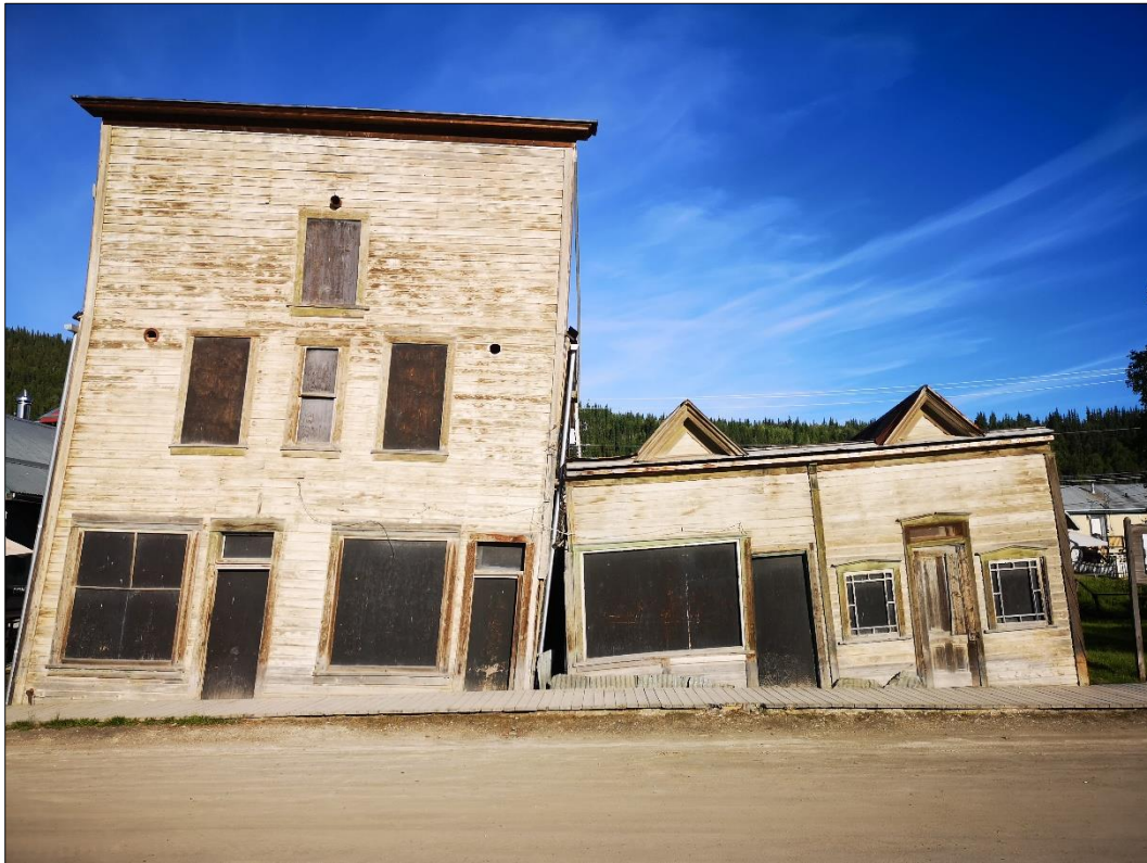
Dawson. Podręcznikowy (dosłownie) przykład szkód budowlanych wywołanych tajaniem permafrostu.
