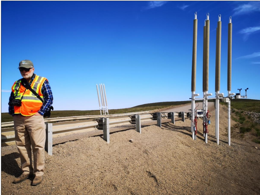
Termosyfony służące do obniżania temperatury gruntu metodą pasywnej wymiany ciepła.
