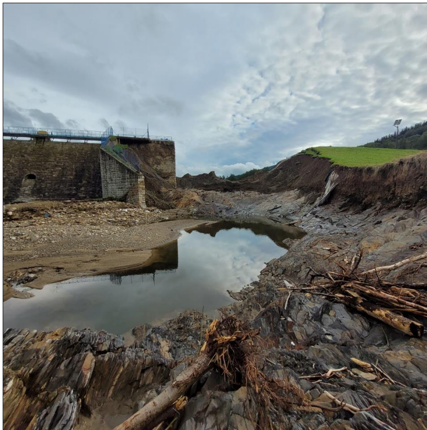
Skutki przerwania nasypu zapory w Stroniu Śląskim.
